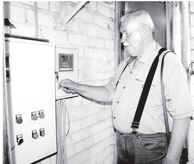
▲ 8 августа. Николай Облётов у шкафа управления ИТП в доме №41 на ул. Степана Разина
